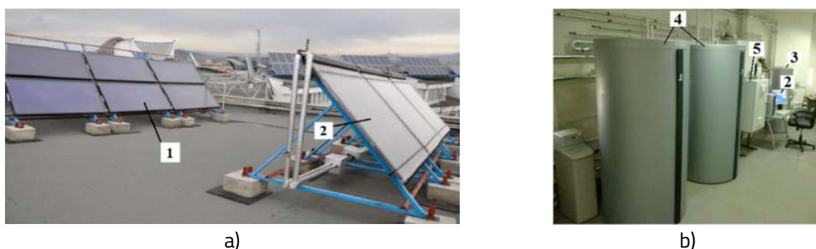
Fig. 2.10 Sistemul solar termic instalat pe Colina Universității Transilvania din Brașov: colectoarele solar termice instalate pe acoperiș (a), boilerul și stocatoarele instalate în laborator (b) [Moldovan et al, 2020a]
