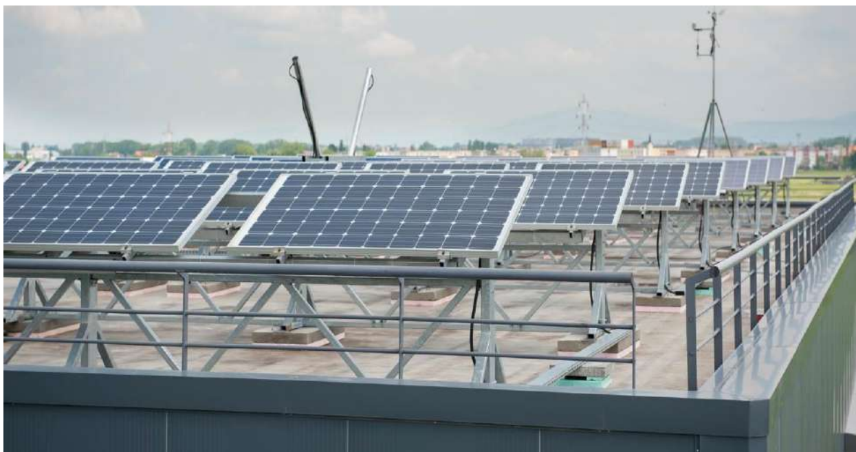
Fig. II.3 Sistem cu șiruri fotovoltaice cu orientare monoaxială instalat pe laboratorul L11
