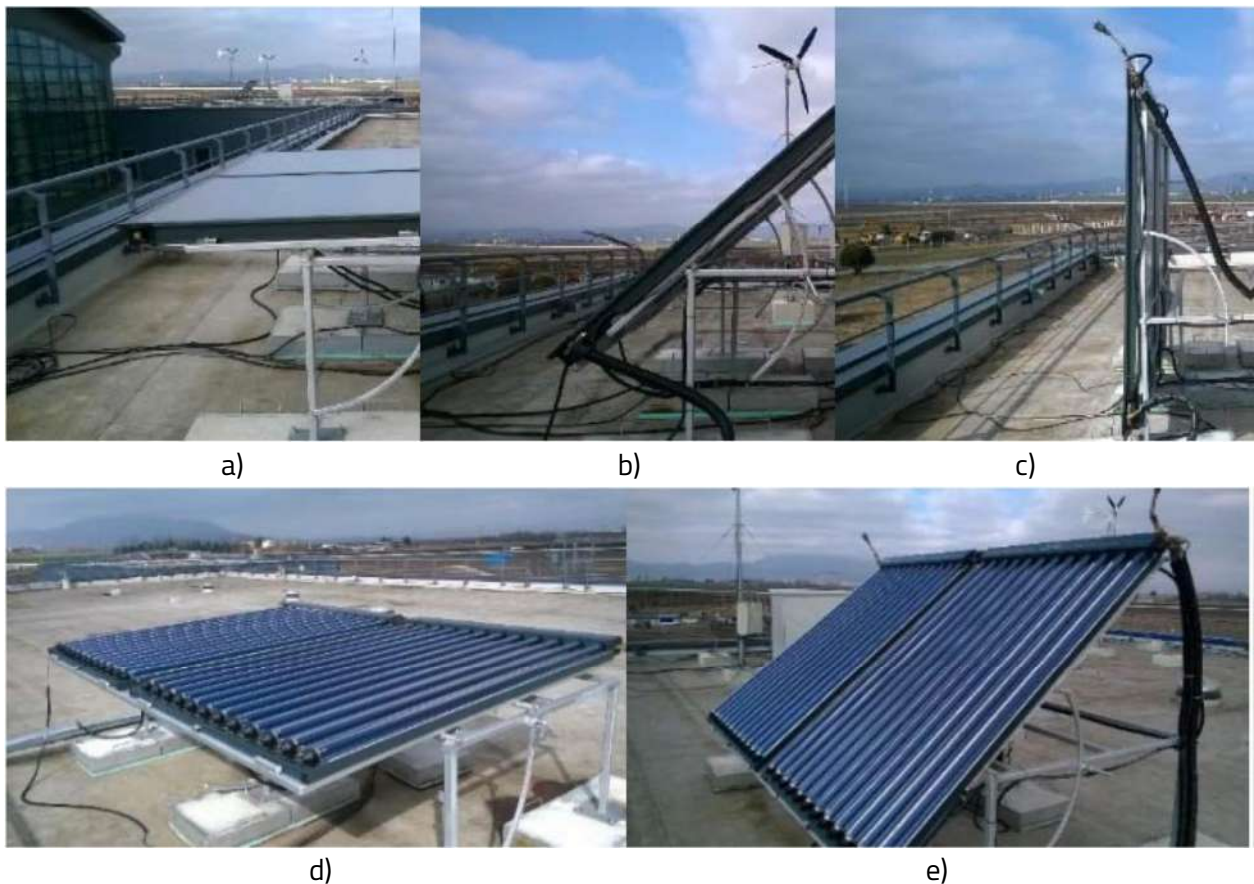
Fig. 2.16 Colectoare solar termice plan plate instalate orizontal (a), înclinat la 45^\circ (b) și vertical (c), și cu tuburi vidate instalate orizontal (d) și înclinat la 45^\circ (e)
