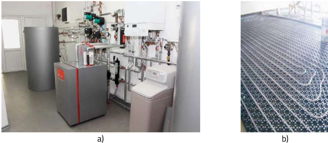
Fig. 1.15 Componentele principale ale sistemului de încălzire a Căsuței Solare: a) pompa de căldură sol-apă, b) sistemul de încălzire în pardoseală
