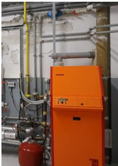
Cazan gaz Ph=63kW Contor energie termică
