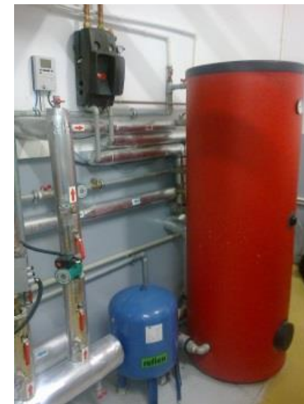
Boiler bivalent 500 litri Contor energie termică
