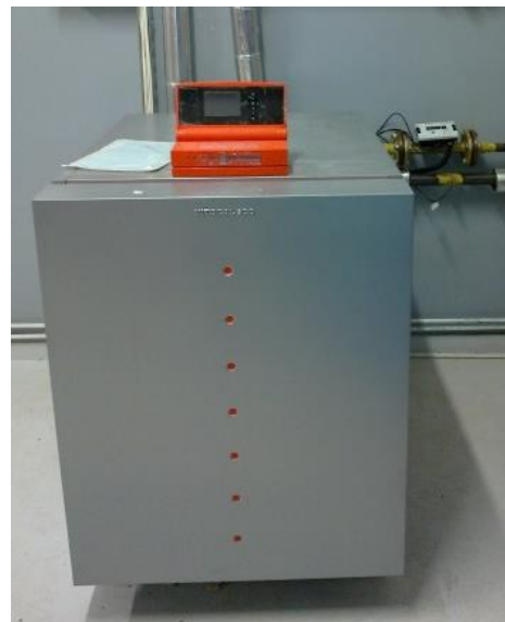
Pompă de căldură Ph=21,2kW Contor energie termică
