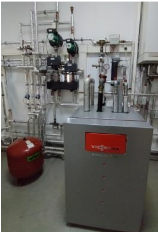
Pompă de căldură sol-apă și contoare energie termică
