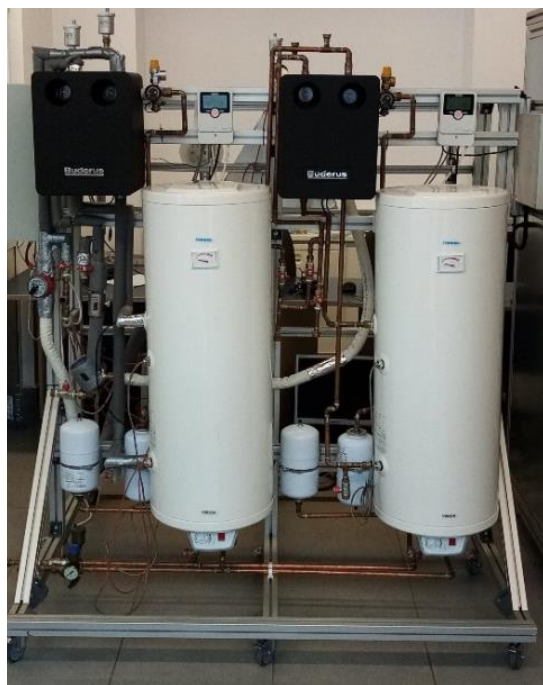
Zona instalare boilere şi grupuri de pompare
