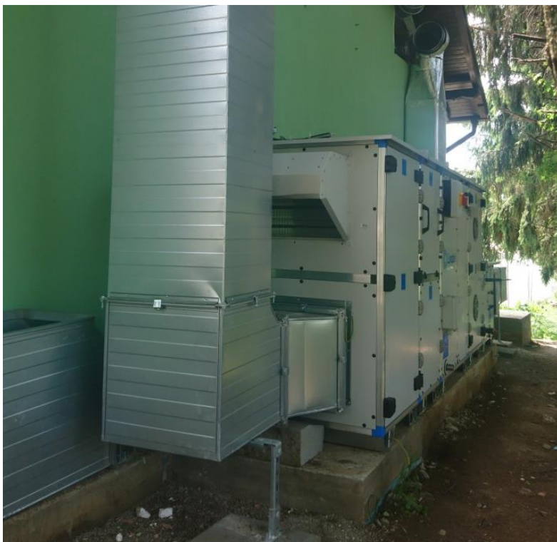
Centrala tratare aer 3300 m 3 /h Recuperator energie termică 87%
