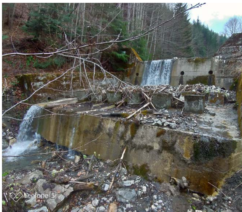
Fig. 5.35. Apron undermining Structure 11 B 2,5 - Nanului Creek
